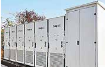
Gewerbespeicher bieten hohe Kapazität bis 200 kWh GSTECHNIK
