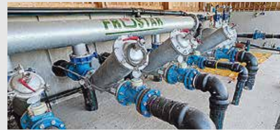
Investitionen in die Infrastruktur sind ein wesentlicher Teil der Sicherungsstrategie MUSCH
