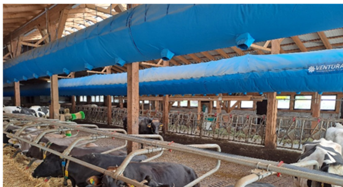
Schlauchlüftung: Tubes werden individuell berechnet und an den Stall angepasst
