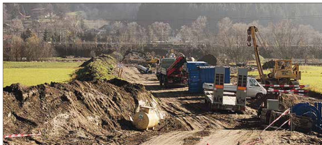
Solche Baustellen können sich jahrelang auf die Ertragsfähigkeit der landwirtschaftlichen Fläche auswirken POMMER
