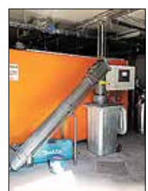
Die Geflügelställe von Familie Stöger sind sehr energieeffizient
