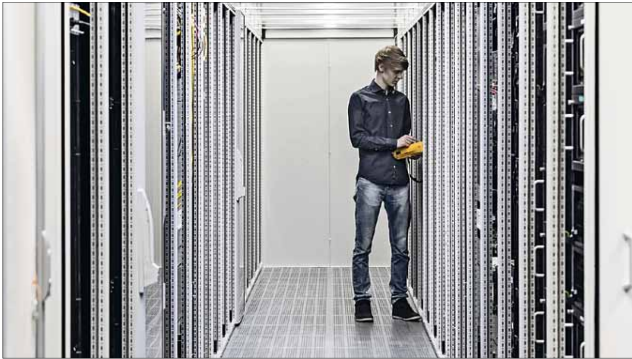
10.000 Server im Raiffeisen Rechenzentrum in Graz-Grambach. Höchste Anforderungen an Sicherheit und Qualität werden geboten RAIFFEISEN
