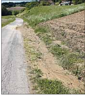
Straße, Graben verschmutzt
